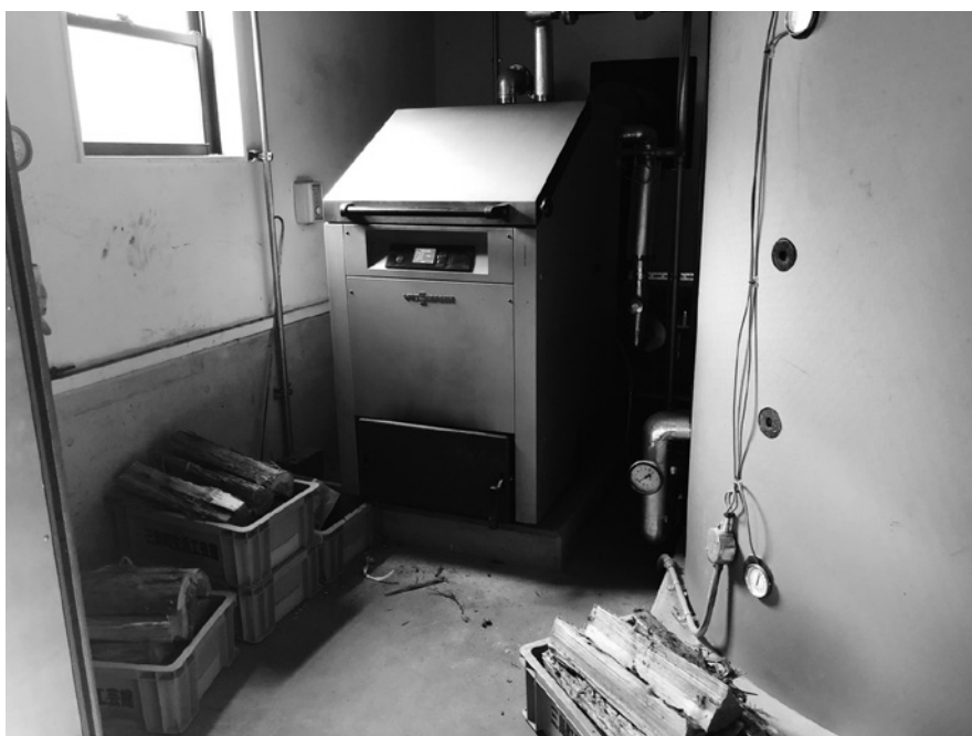
生活工芸館に設置されている「薪ボイラー」
