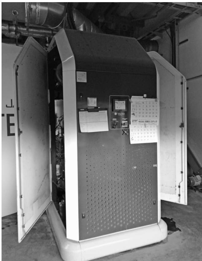
木質バイオマス小型発電設備
