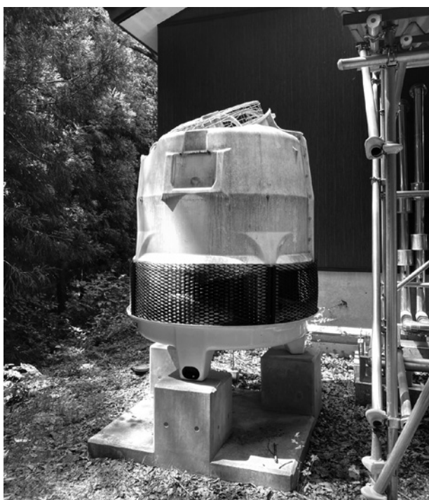
生活工芸館冷暖房設備改修工事 (クーリングタワー)
